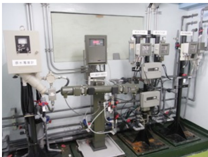
↑ 青葉第二浄水場内「設備機器」
