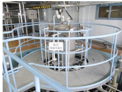
↑ 青葉第二浄水場内「設備機器」
